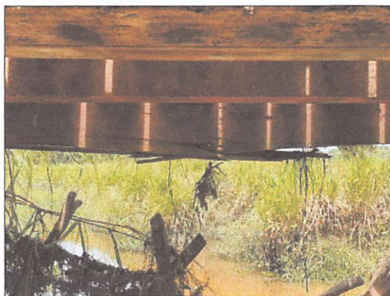
Foto 03: Fissura em Longarina
