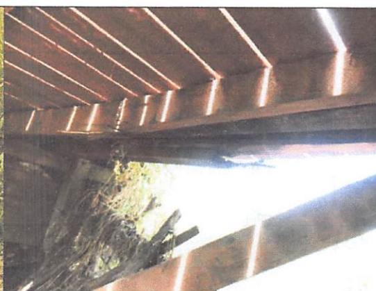
Foto 02: Fissura em Longarina
