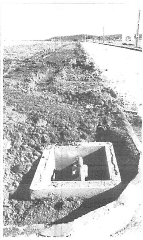
Foto 9: Caixas de Manobra e Registro – Rede Água
